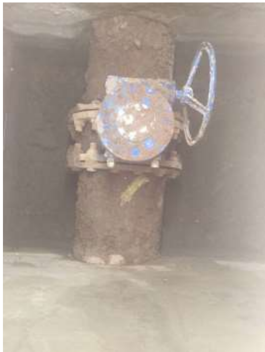
厂区总切断阀
